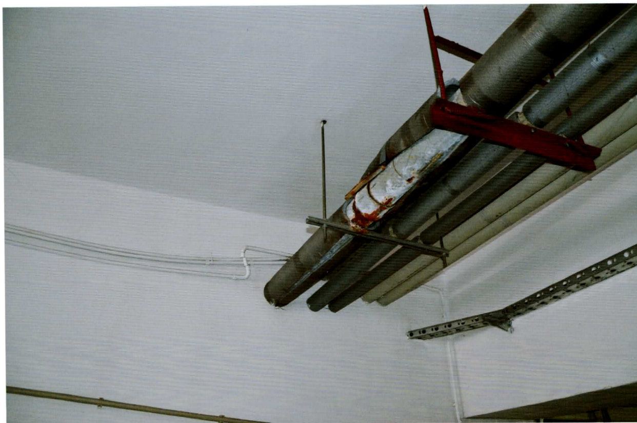
Zdjęcie 30. Skorodowana instalacja.
