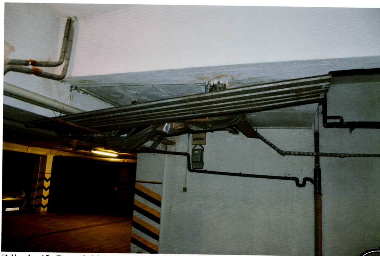
Zdjęcie 42. Przecieki w garażu.
