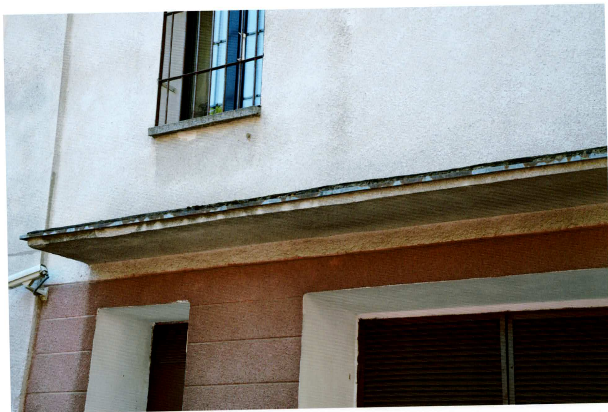
Zdjęcie 9. Skorodowana obróbka daszku.
