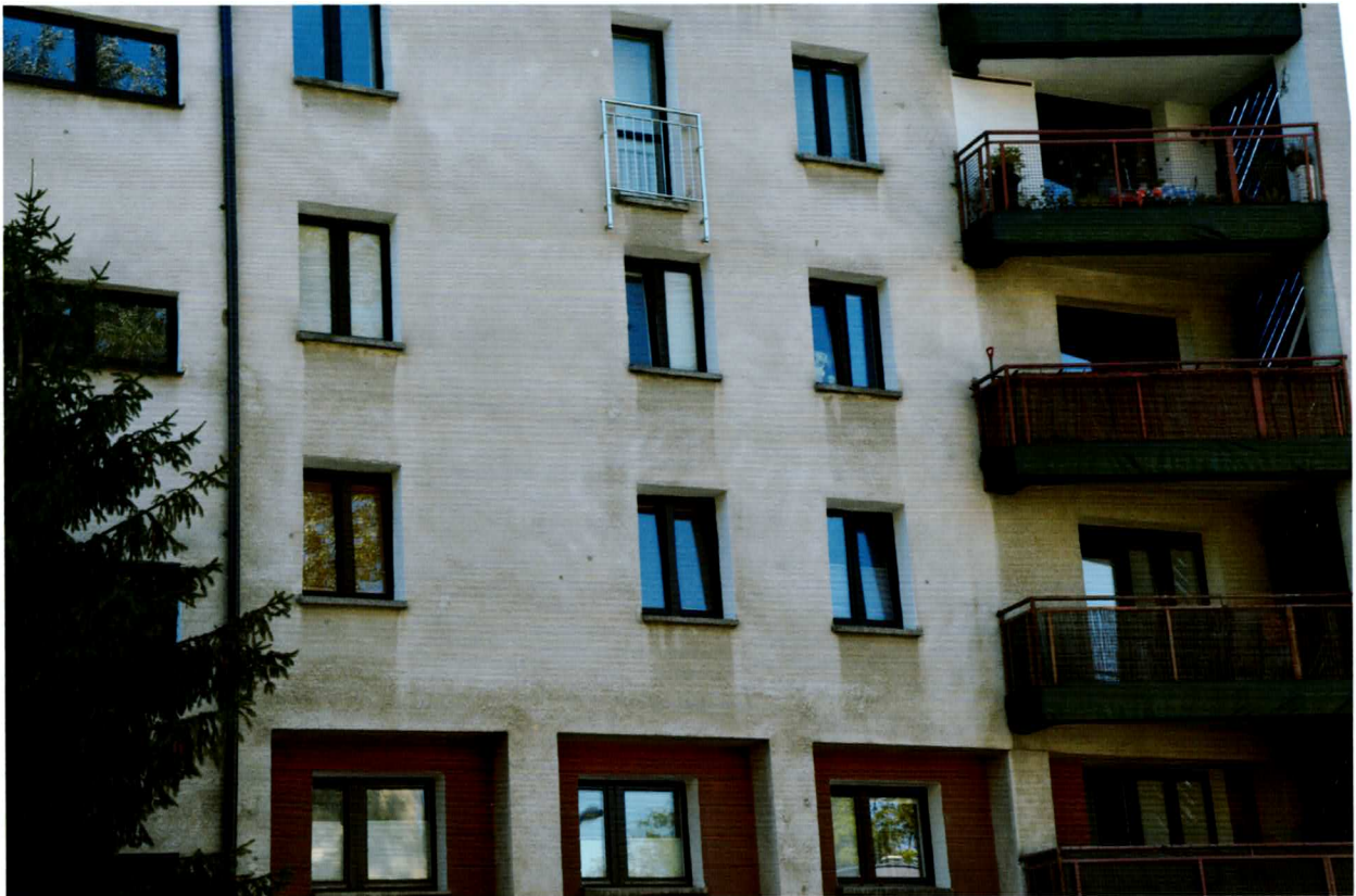
Zdjęcie 31. Zabezpieczone płyty balkonowe, brudna elewacja.
