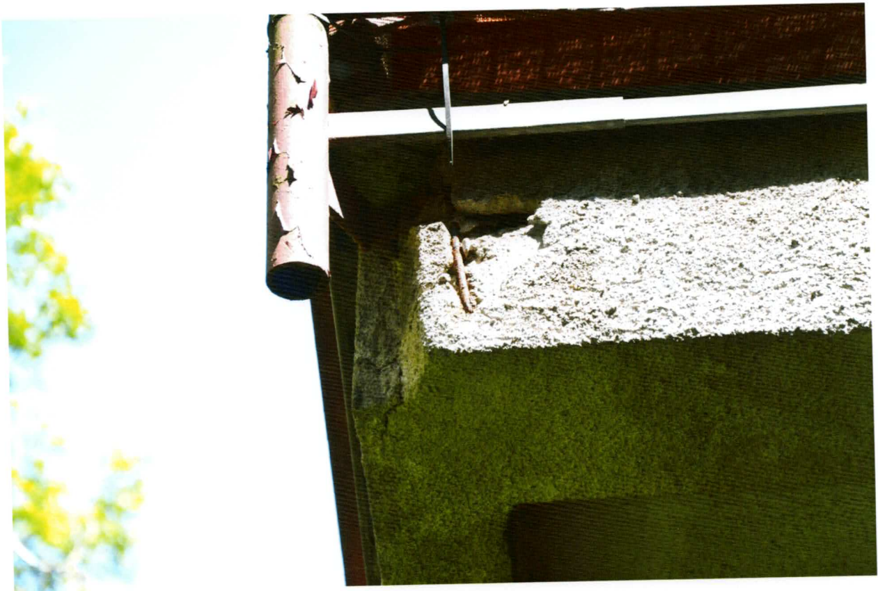
Zdjęcie 7. Uszkodzona płyta balkonowa.
