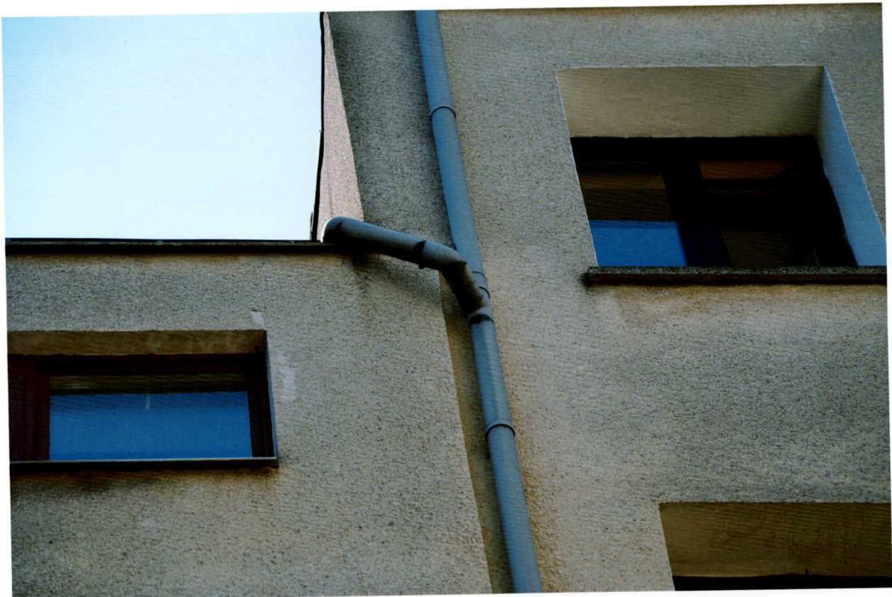
Zdjęcie 21. Uszkodzona rura spustowa.
