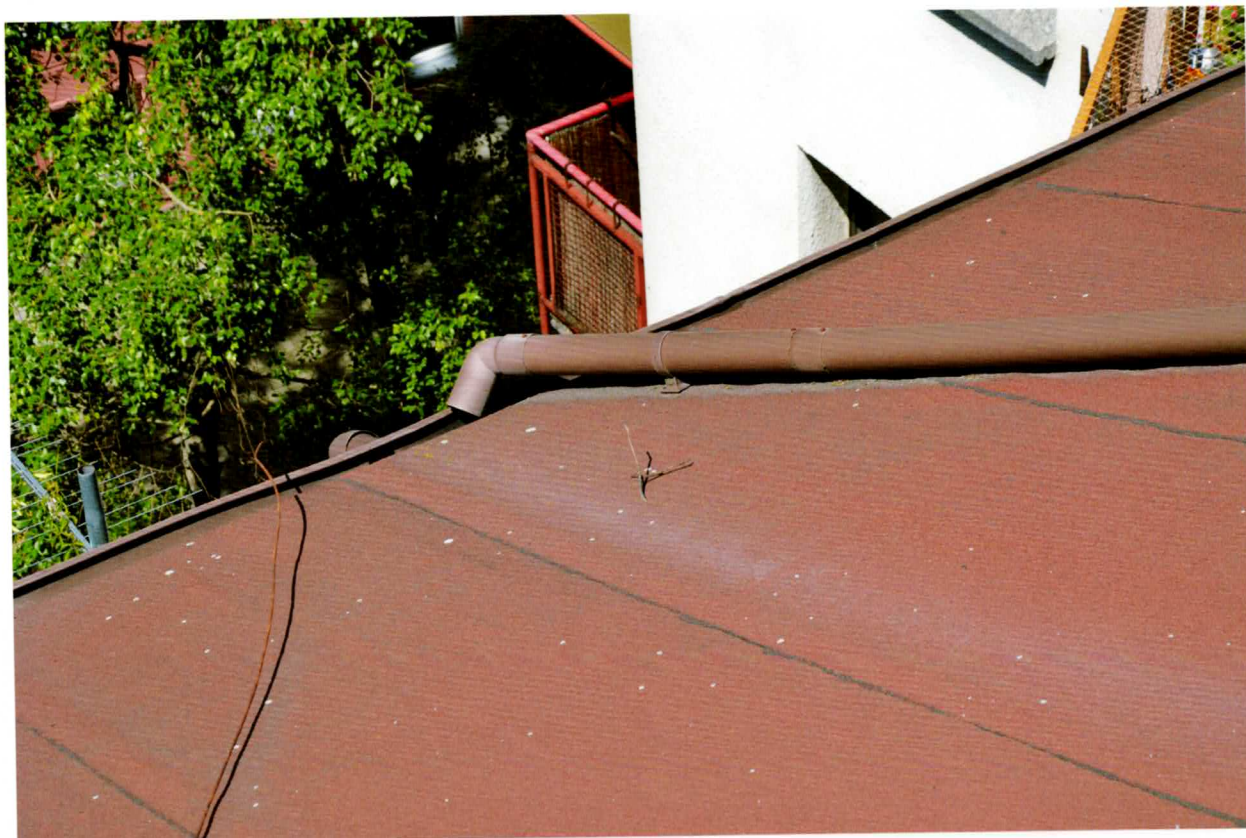
Zdjęcie 25. Brak kosza spustowego.
