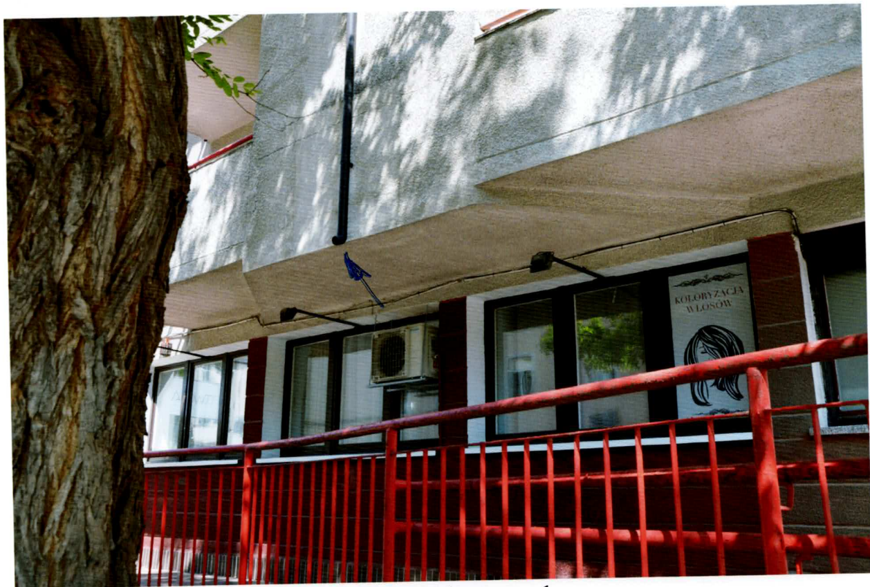
Zdjęcie 19. Rura spustowa zakończona zbyt wysoko.
