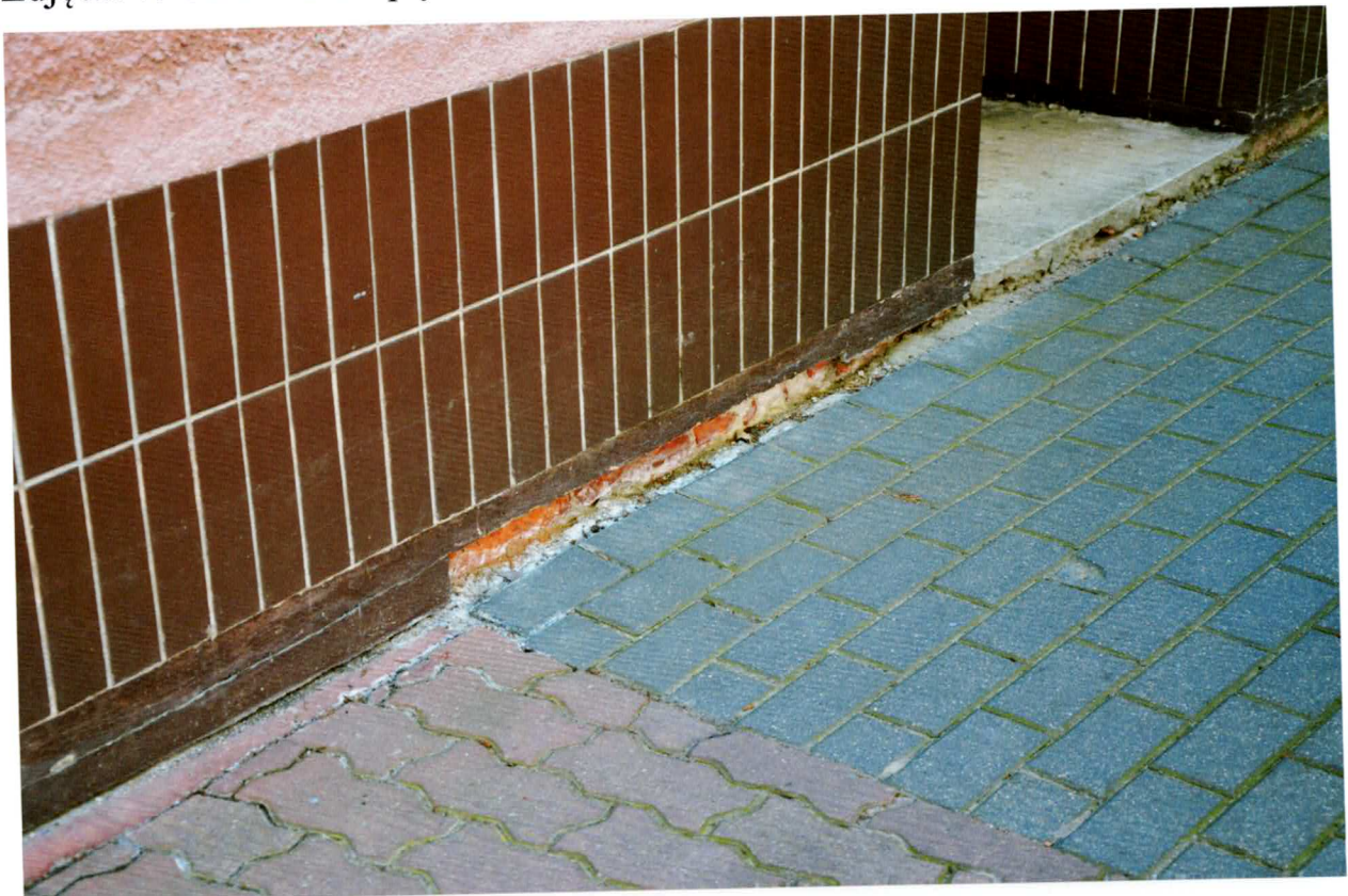
Zdjęcie 8. Uszkodzony cokół.
