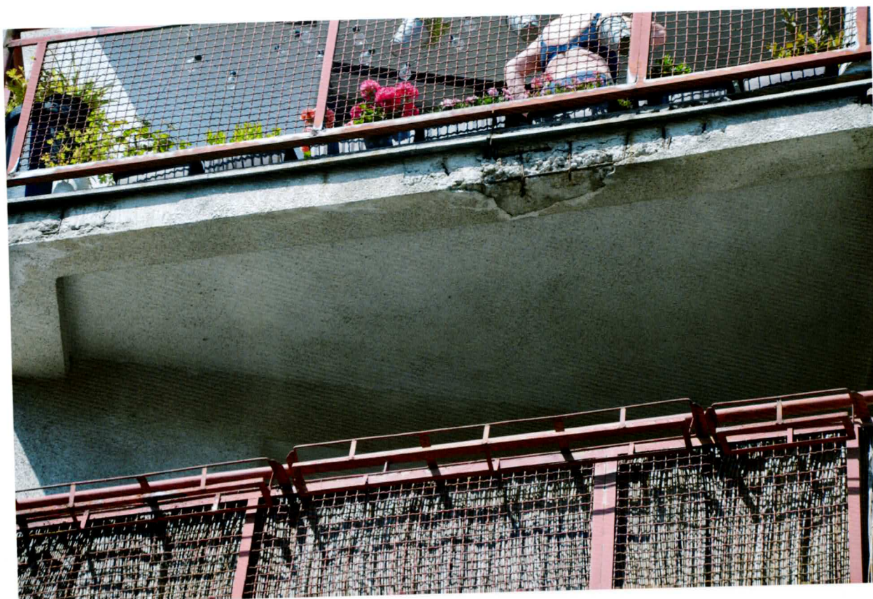
Zdjęcie 11. Uszkodzona płyta balkonowa.
