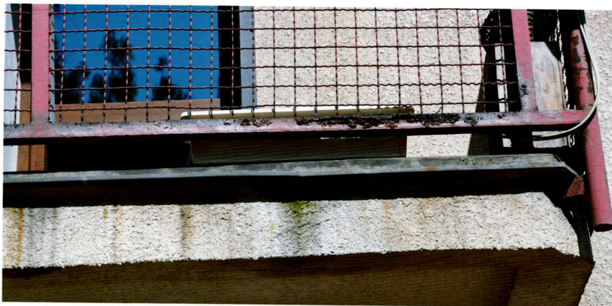
Zdjęcie 39. Skorodowana barierka balkonowa.
