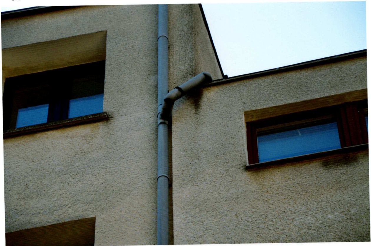
Zdjęcie 22. Uszkodzona rura spustowa.
