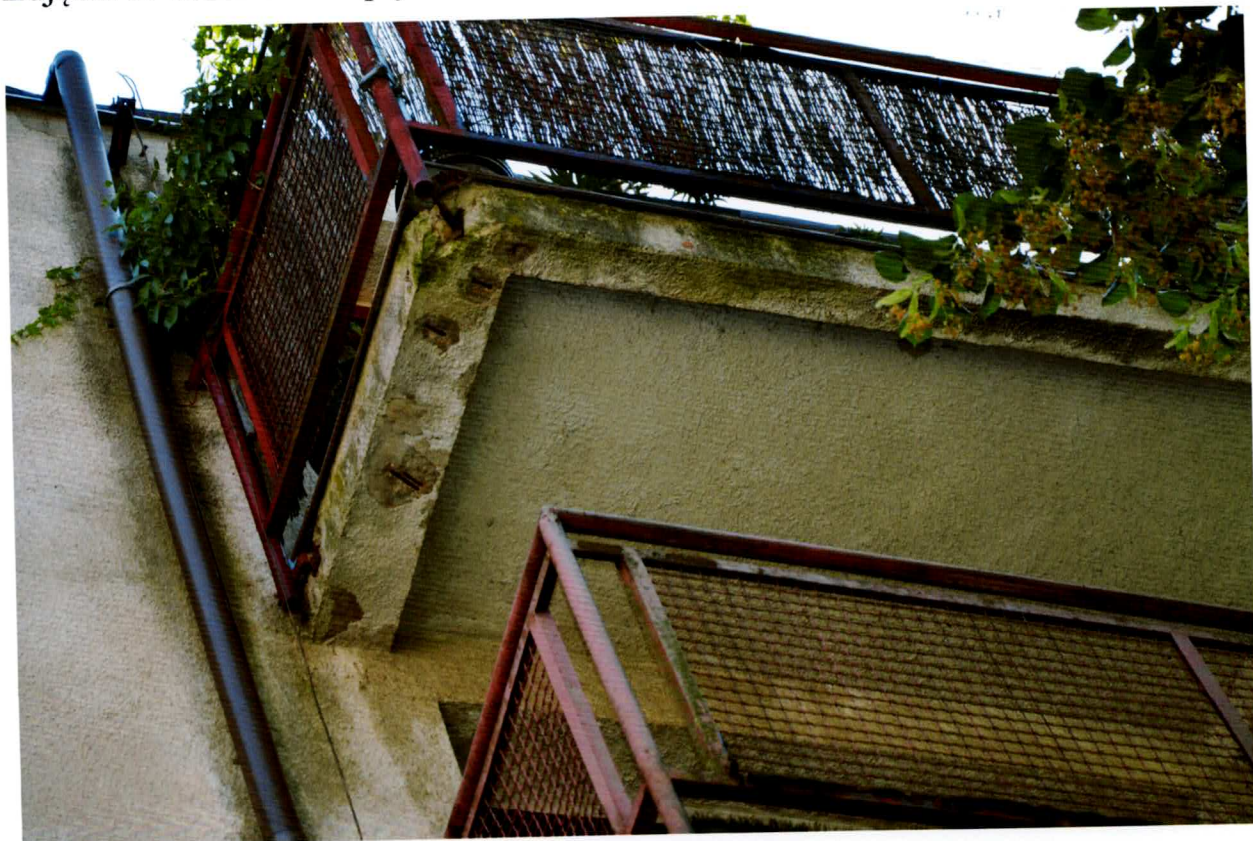
Zdjęcie 6. Uszkodzona płyta balkonowa.
