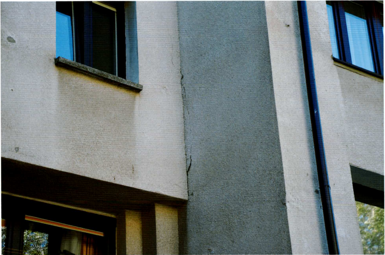
Zdjęcie 37. Spękanie na dylatacji.
