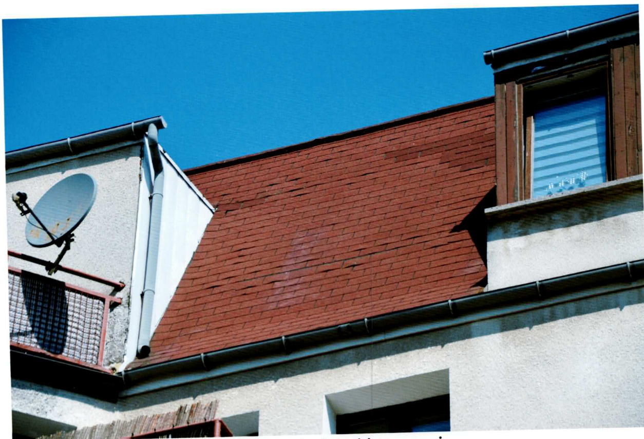
Zdjęcie 17. Uszkodzone pokrycie z dachówki papowej.
