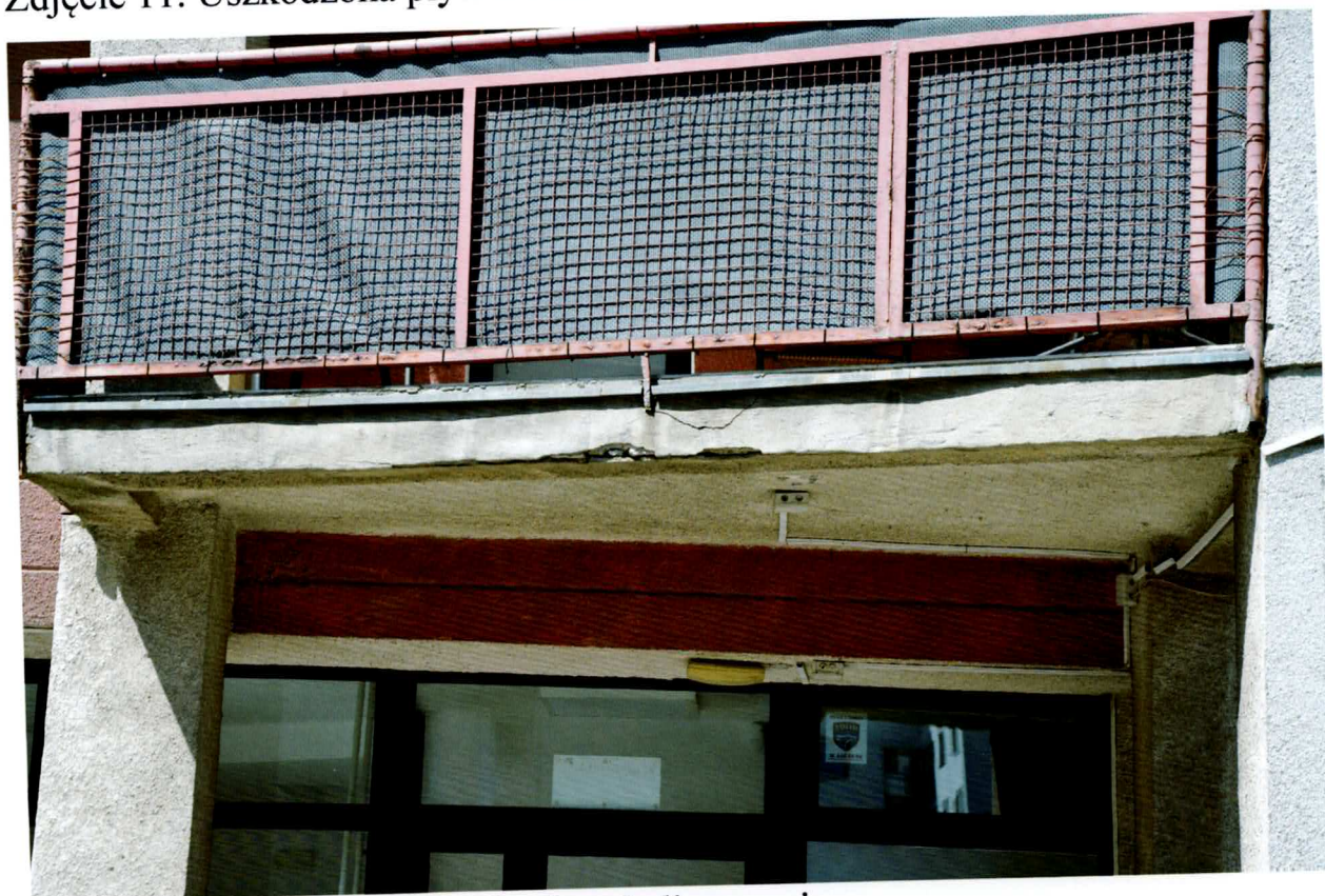
Zdjęcie 12. Uszkodzone czoło płyty balkonowej.
