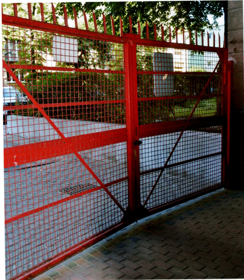
Zdjęcie 43. Źle działająca brama wjazdowa.
