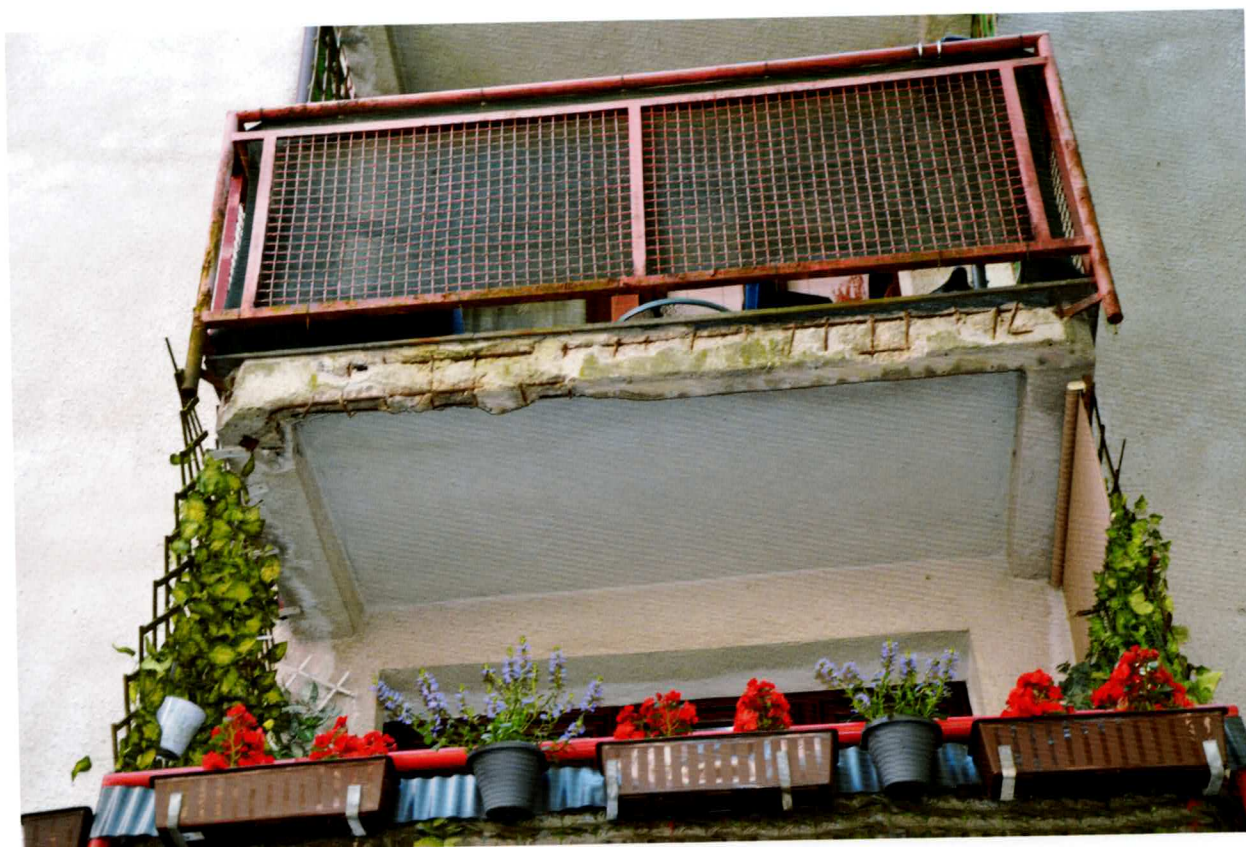
Zdjęcie 5. Uszkodzona płyta balkonowa.
