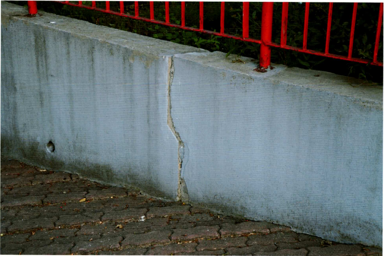
Zdjęcie 33. Pęknięty mur oporowy.
