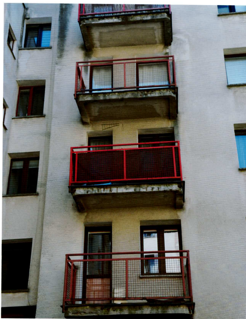
Zdjęcie 40. Zniszczone płyty balkonowe.
