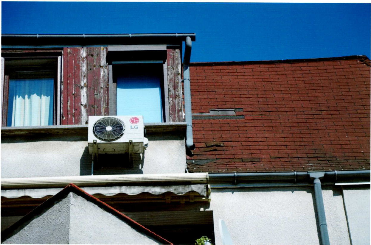
Zdjęcie 34. Pokrycie mansard i boazeria do remontu.
