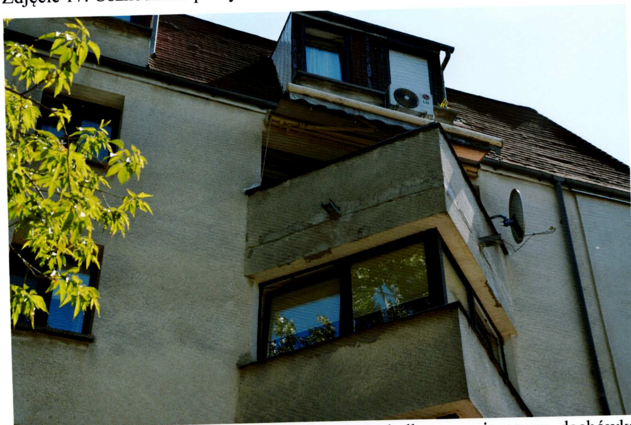
Zdjęcie 18. Uszkodzona barierka murowana balkonu, zniszczona dachówka papowa.
