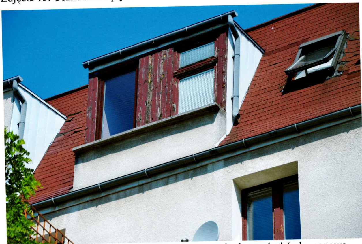
Zdjęcie 16. Zniszczona okładzina drewniana, uszkodzona dachówka papowa.
