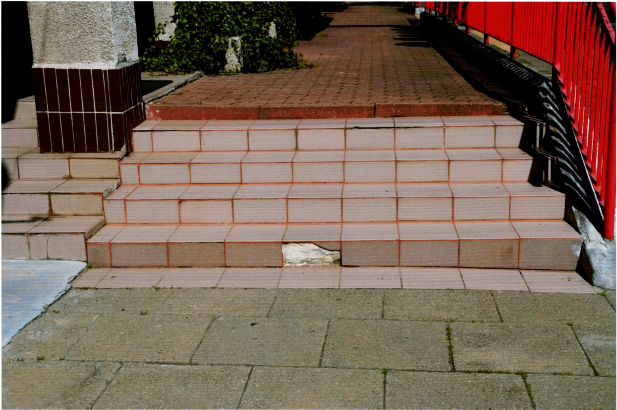
Zdjęcie 35. Uszkodzona płytki schodów wejściowych.
