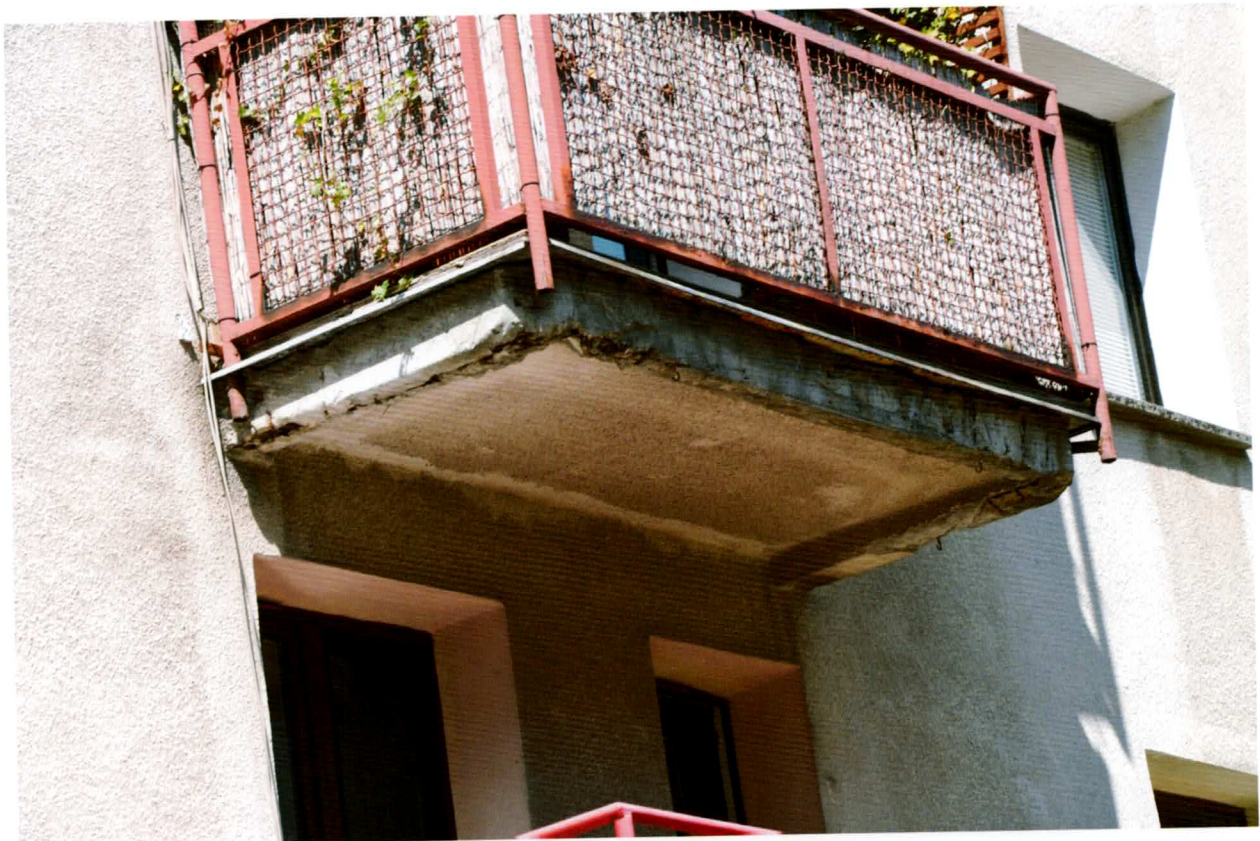
Zdjęcie 23. Uszkodzona płyta balkonowa.
