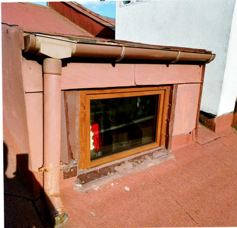
Zdjęcie 47. Brak obróbki okna lukarny.
